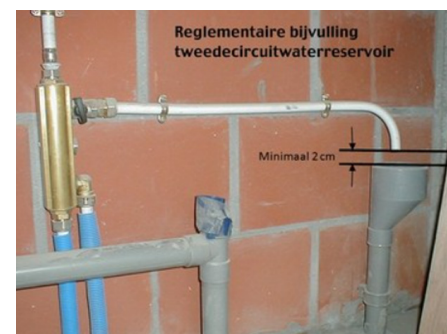
Figuur 5 Fysieke onderbreking tussen twee watercircuits
