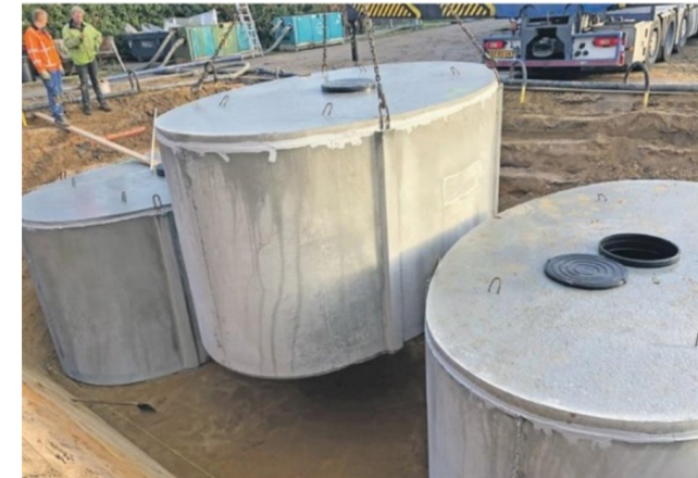
Figuur 3 Installatie van een hemelwaterput. Bron: GEP
