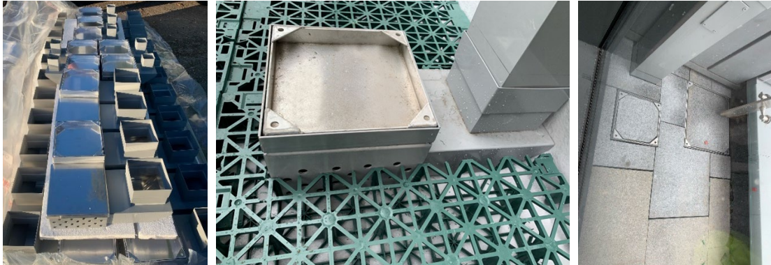
De verdeelkamers worden geleverd (links) en geïnstalleerd tussen aangrenzende retentievolumes (midden) en voltooide installatie met bestratingsafdekkingen (rechts)
